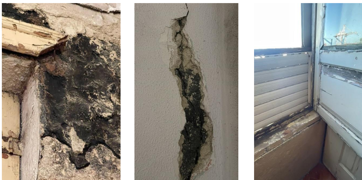
Imagem 106, 107 e 108: Danos Causados por Humidade, Fissuras e Podridão, respetivamente.
