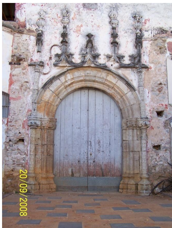
Figura 15- Convento das Bernardas, Tavira - Portal manuelino da antiga igreja (estado antes da reabilitação), 2008.
