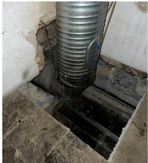
Figura 66- Abertura indevida em laje para passagem de conduta metálica, com desagregação do reboco e perda de continuidade estrutural. (2024):
