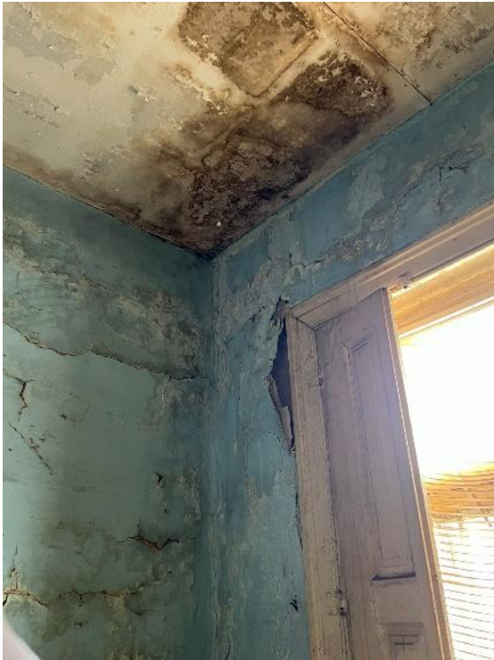
Figura 61- Degradação avançada por humidade numa divisão junto a vão de janela: delaminação e pulverulência do reboco no teto, fendas verticais na parede. (2024).
