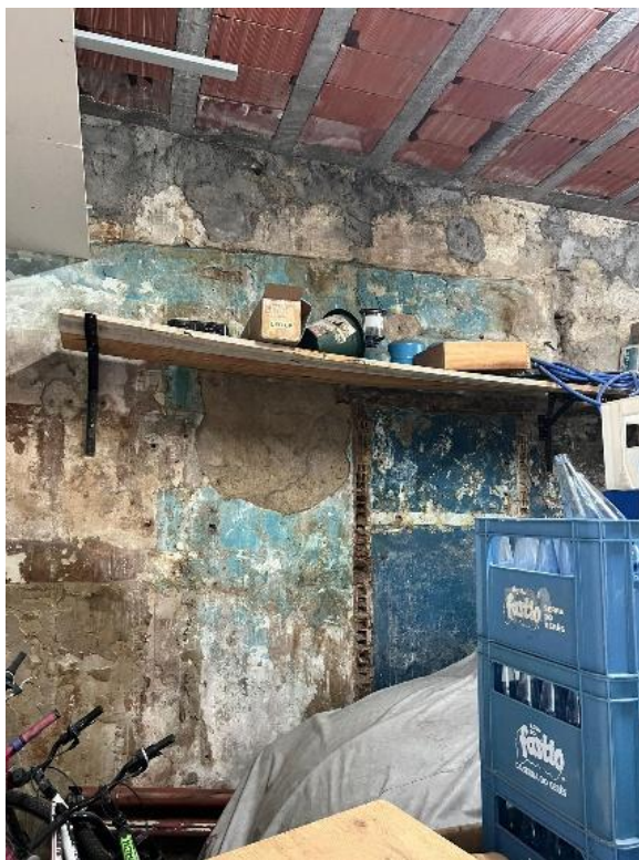
Figura 72- Espaço de garagem/arrumos sem acabamento: paredes com rebocos muito degradados e roços abertos, teto de vigotas e abobadilhas exposto e sinais de humidade-evidência de uso provisório e manutenção precária (2024).
