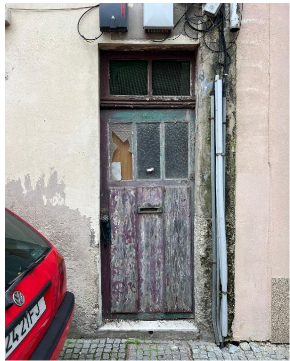
Figura 71- Vão exterior e caixilharia em mau estado. Porta e envidraçados partidos, madeiras apodrecidas, cablagens aparentes e ausência de cuidado nos acabamentos. (2024).
