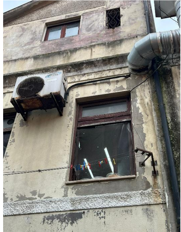
Figura 69- Fachada tardoz com tinta descascada e reboco degradado. Notam-se destacamentos generalizados, sujidade biológica e acréscimos técnicos dissonantes (unidade de AVAC oxidada, caleira) (2024).
