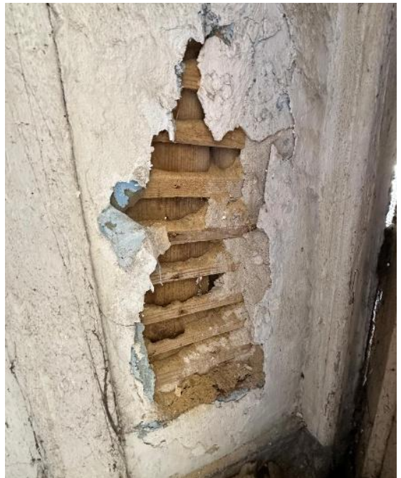
Figura 64- Parede interior em tabique (estrutura de madeira com fasquiado) com reboco de cal destacado e perda de aderência; sinais de humidade ascensional junto ao rodapé (2024).
