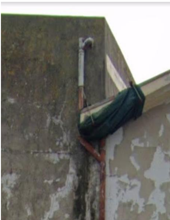
Figura 70- Remate e drenagem pluvial improvisados. Tubagem e caleiro com remendos, pintura descascada e juntas mal acabadas, potenciando infiltrações na fachada tardoz (2024).
