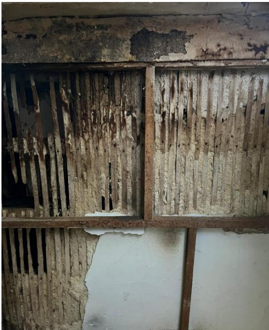
Figura 63- Teto em estuque sobre fasquiado com degradação generalizada do ripado, lacunas de revestimento e manchas de humidade resultantes de infiltrações prolongadas (2024).
