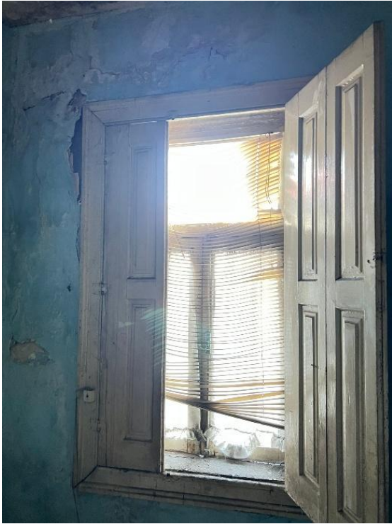
Figura 68- Vão interior com paredes sem acabamento. Fissuração e destacamento de rebocos, guarnições deformadas e estore danificado — evidência de manutenção deficiente dos acabamentos (2024).
