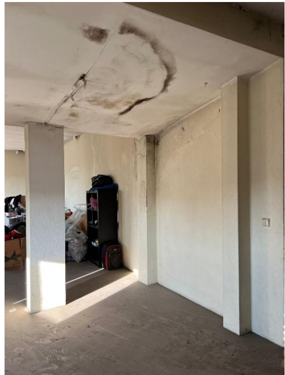
Figura 62- Manchas extensas de infiltração no teto e parede, com halos, sujidade por percolação, fissuração junto às ligações laje-pilar e destacamento de reboco. (2024).
