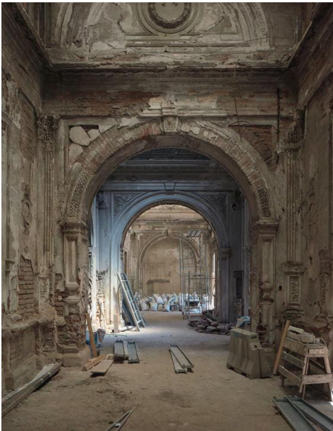
Figura 33- Estado do Palácio Pereira durante as obras de recuperação, evidenciando o avançado estado de degradação em que se encontrava o edifício antes do processo de restauro, s.d.
