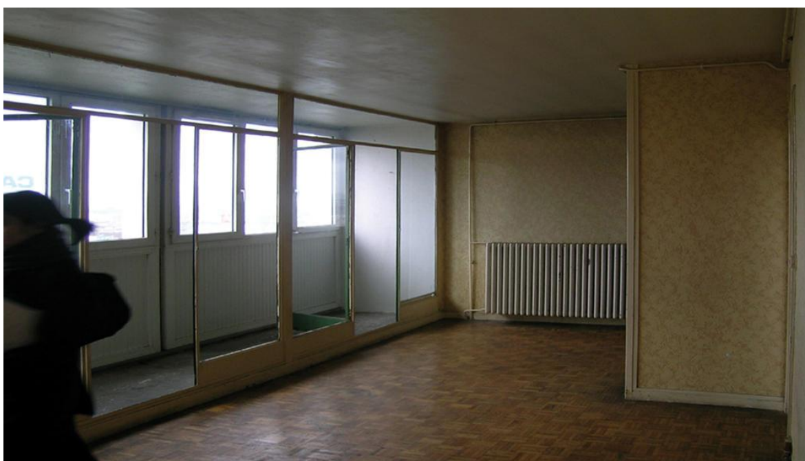
Figura 44- Estado interior de um apartamento da Torre Bois-le-Prêtre antes da intervenção. As fachadas opacas, a compartimentação excessiva e a fraca luminosidade interior traduzem as limitações espaciais e ambientais da configuração original, s.d.
