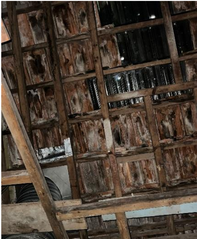
Figura 65- Estrutura de madeira da cobertura com peças degradadas e ausência de telhas em múltiplos panos; recurso a subtelha/plásticos provisórios, originando infiltrações, perda de rigidez e agravamento das ruturas (2024).
