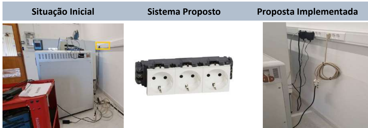
Figura 46 – Implementação da proposta de melhoria dos cabos elétricos.
