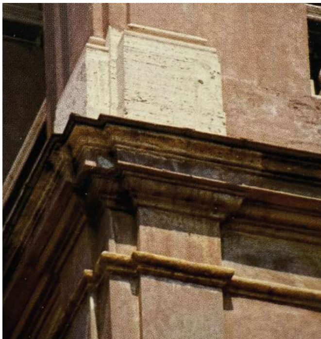
Fig. 12 – Antes das intervenções de Restauro. Estado de degradação das cores do travertino e da pintura
