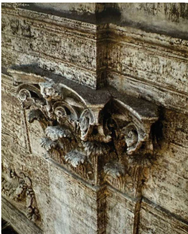
Fig. 18 – Capitel da igreja antes da intervenção
