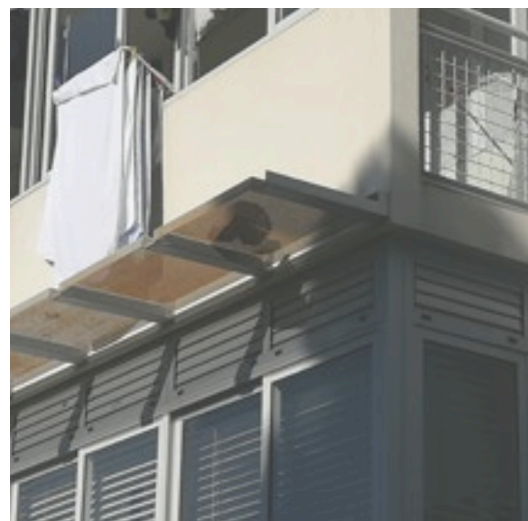
Fig. 116 A oxidação das grelhas de sombreamento após a reabilitação. Autor: desconhecido.
