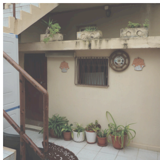
Fig. 72 Construção ilegal feito por um dos moradores. Autor: Ana Lima.
