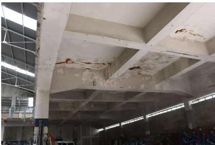
Figura 60 - Patologias Existentes, 2023. Fonte: Autor
