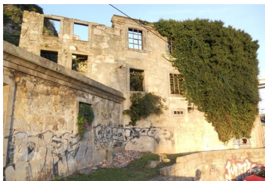
Figura 30 - Fábrica do Carvalhinho após incêndio, fachada Sul.
