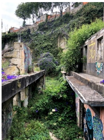
F4-Estado conservação pavimentos
