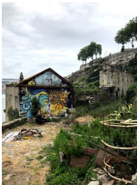
F6-Estado conservação fachada da Capela
