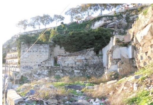
Figura 31 - Fábrica do Carvalhinho após incêndio, fachada Este.
