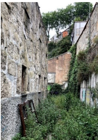
F3-Estado conservação paredes exteriores
