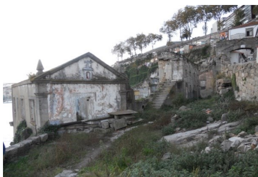
Figura 32 - Fábrica do Carvalhinho após incêndio, fachada Norte.
