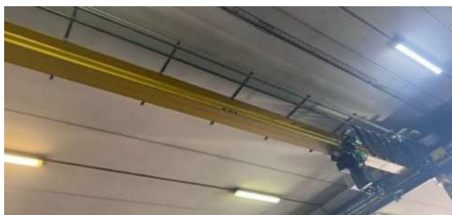
Figura 23 - Ponte rolante com capacidade máxima de 5 toneladas.
