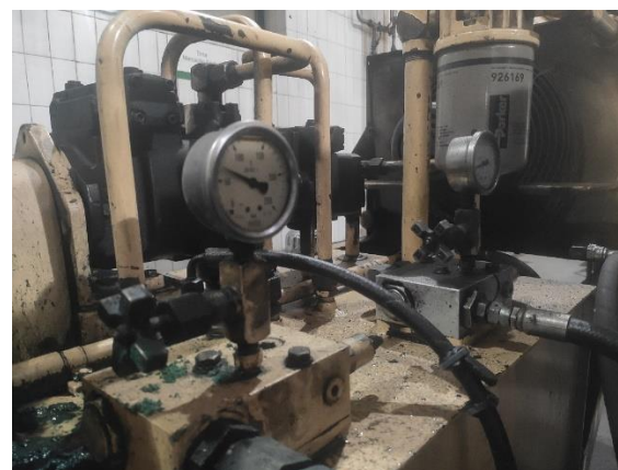
Figura 21 - Válvulas para regulação de pressão hidráulica (Navigator Pulp Aveiro, 2023).
