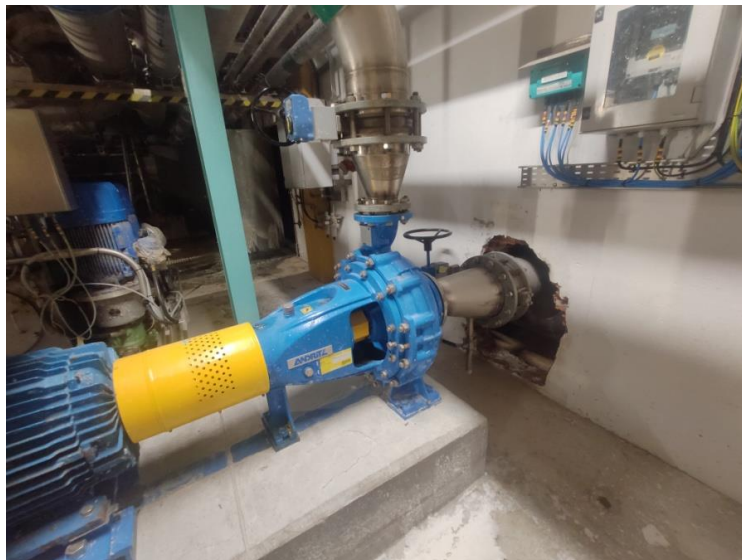
Figura 24 - Motor elétrico acoplado a bomba industrial (Navigator Pulp Aveiro, 2023).
