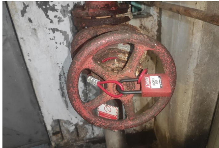
Figura 26 - Válvula de alimentação de água para rede de incêndios (Navigator Pulp Aveiro, 2023).
