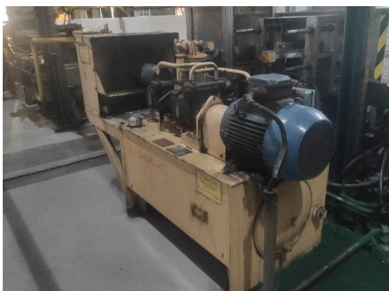
Figura 20 - Unidade hidráulica para máquinas e equipamentos hidráulicos (Navigator Pulp Aveiro, 2023).
