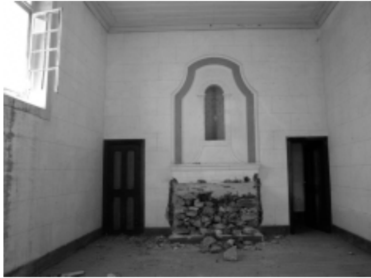
Ilustração 71 – Interior da capela, em profundo estado de abandono. 2015 (cortesia do Arquiteto João Mendes Ribeiro, 2019).
