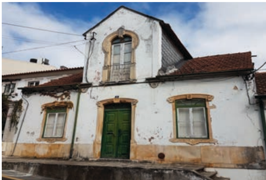
Ilustração 41 - Fachada Principal de uma moradia do conjunto habitacional: Avenida Dr. José Jardim (Ilustração nossa, 2017)
