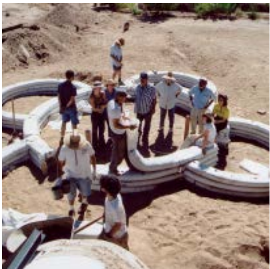
Ilustração 93 – Colocação dos sacos de areia para formação da estrutura do módulo. ([Adaptada a partir de:] Cal-Earth, 2016).
