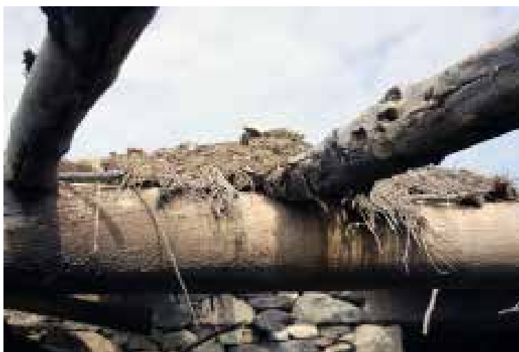
Ilustração 207 – Pormenor do toro central de madeira e dos caibros da cobertura de salão. (Ilustração nossa, 2016).
