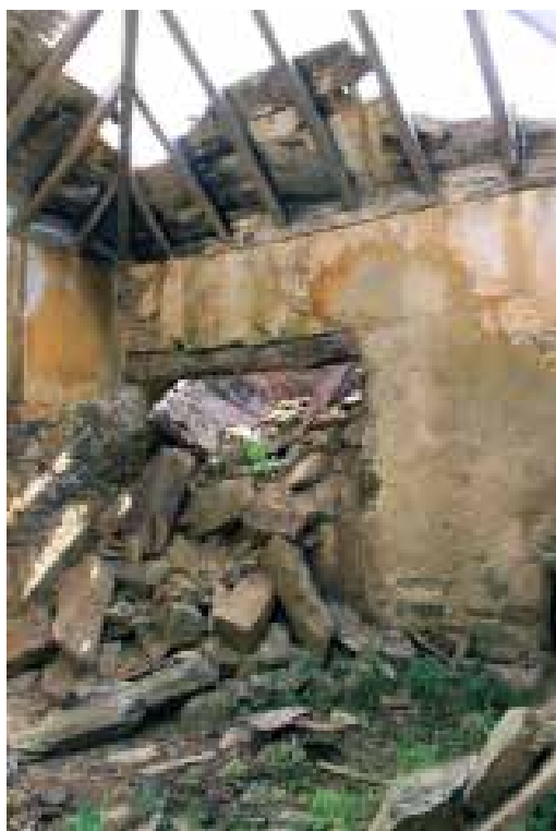
Ilustração 143 – Forno da cozinha da casa de salão. (Ilustração nossa, 2016).
