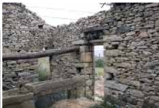
Ilustração 119 – Vista interior das fachadas Este e Sul do palheiro com vista para o vão de entrada. (Ilustração nossa, 2016).
