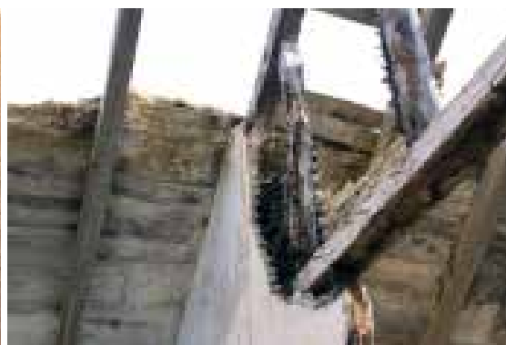
Ilustração 142 – Pormenor da armação da parede divisória – tabique – e da cobertura. (Ilustração nossa, 2016).
