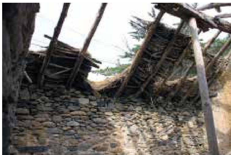
Ilustração 198 - Vista interior da cobertura e paredes do palheiro e estábulo. (Ilustração nossa, 2016).
